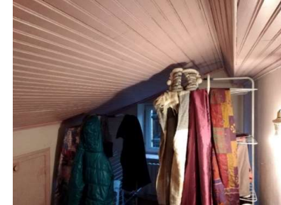
Hauteur sous-plafond insuffisante dans une pièce
