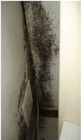
Traces de moisissures
